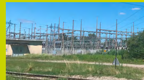
Poste électrique d'Ottmarsheim, sur lequel la centrale photovoltaïque sera raccordée
